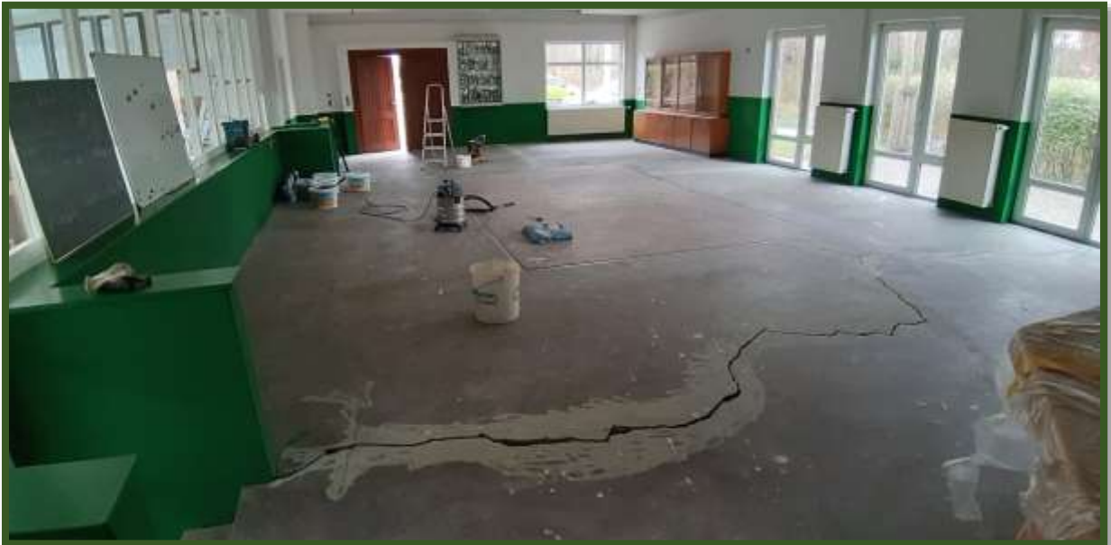
Der alte Fußboden mit den entstandenen Fugenrissen.
